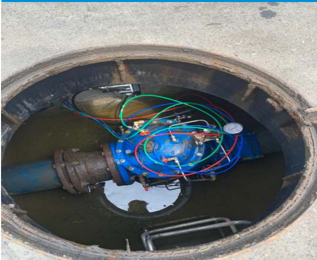
Philippin - Điều khiển Từ xa PRV tại Manila
