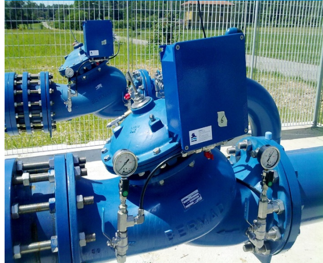
Nước Ý - Hệ thống Kiểm soát Áp suất Simbrivio
