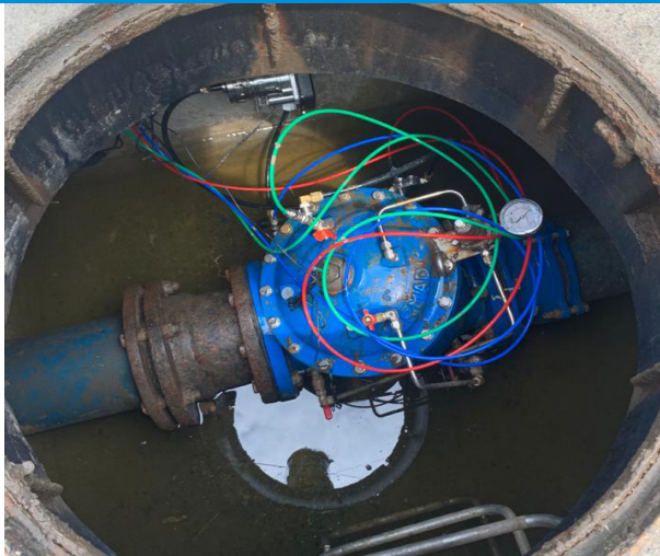
Filipina - PRV kendali jarak jauh di Manila
